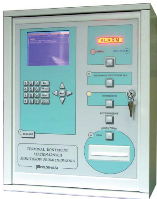
Fot. 5. Terminal kontrolny stacjonarnych monitorów promieniowania TK-1
