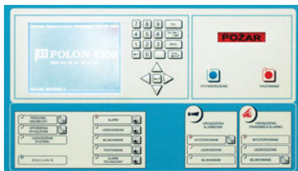
Fot. 3. Część „pożarowa” centrali POLON 4500
