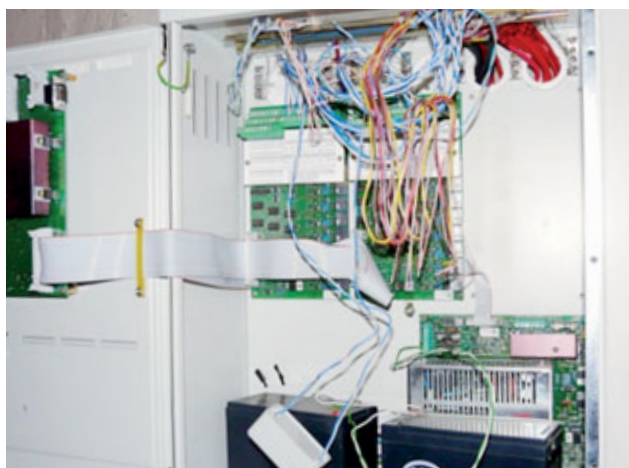
Fot. 4. Niedbałe pozostawienie przewodów instalacyjnych, które może skutkować zakłóceniem pracy centrali
