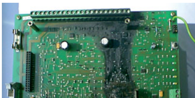
Fot. 1. Skutek nieprawidłowych połączeń
