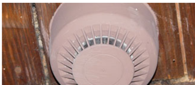
Fot. 3. Samodzielne malowanie czujek czującej urządzenia – zniszczenie uszczelnień gniazda czujki
