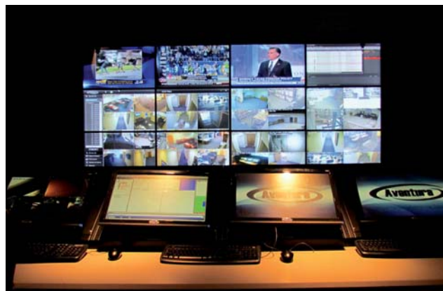
Fot. 6. System wyświetlania obrazów video wall firmy Aventura
