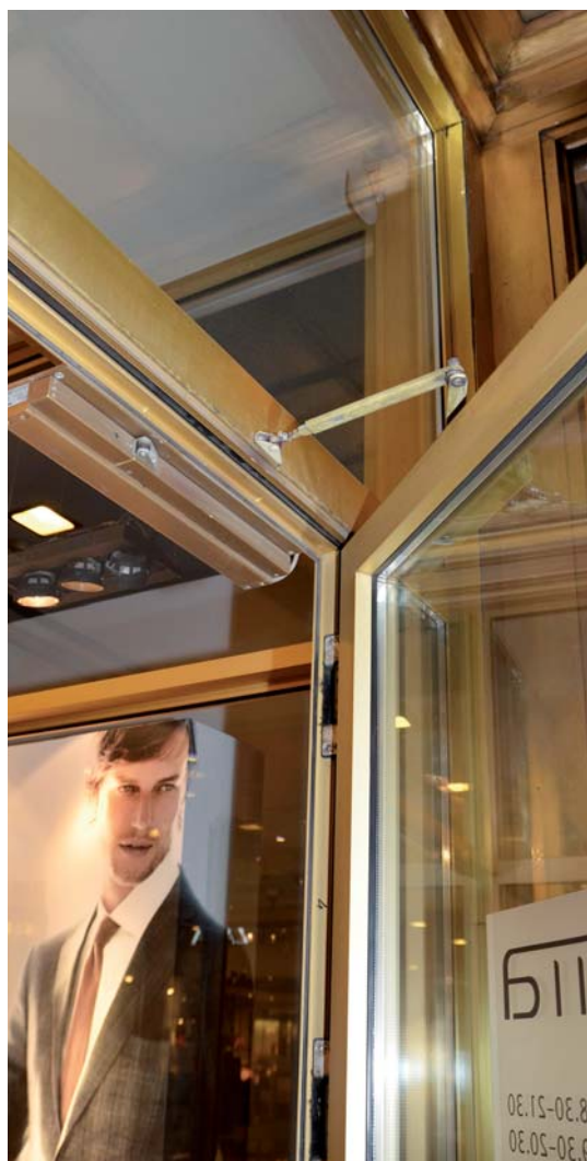
Fot. 2. Napęd drzwiowy DDS w zastosowaniu – Dom Handlowy „Renoma” we Wrocławiu
