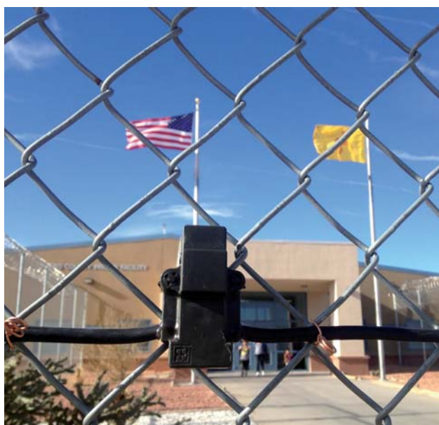
Fot. 2. Czujnik SL-3 zainstalowany na siatce ogrodzeniowej
