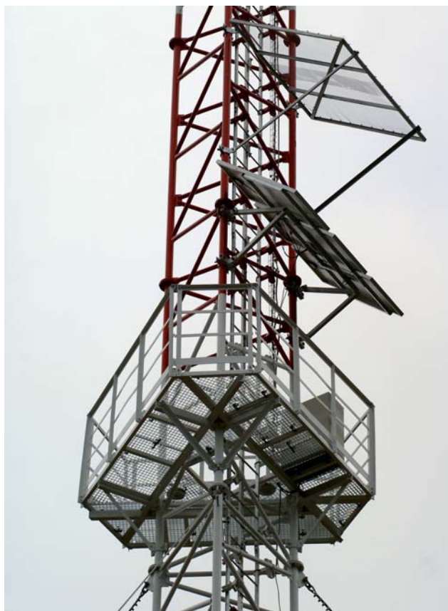
Fot. 2. System zasilania fotowoltaicznego wieży z kamerą
