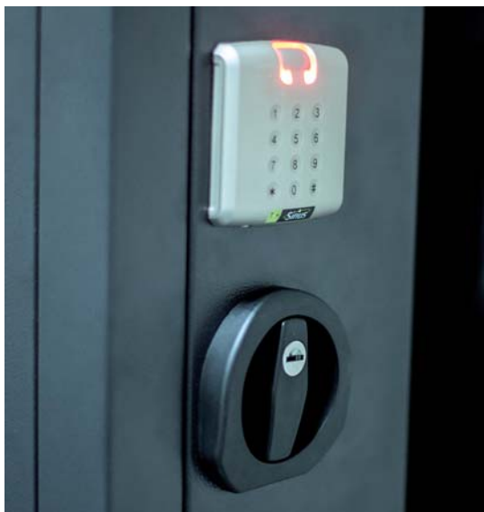
Fot. 2. Szafa teleinformatyczna 19" z zamknięciem sterowanym przez system kontroli dostępu
