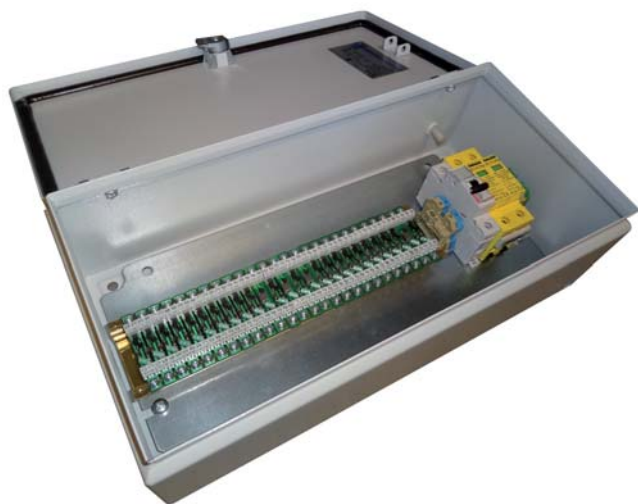
Fot. 1. Złącze ochrony przed przepięciami centrali alarmowej
