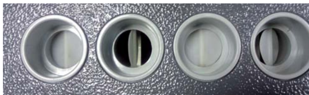
Fot. 1. Zawory czujki VESDA Laser Scanner rozróżniającej cztery rury zasysające grube, o średnicach wew./zew. 21 mm/25 mm
