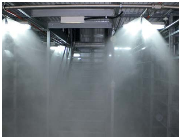
Fot. 1. Gaszenie mgłą wodną
