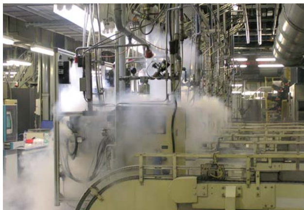
Fot. 7. Gaszenie CO 2
