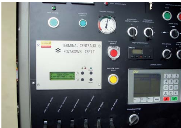
Rys. 7. Widok terminala centrali (szafa sterownicza wagonu)
