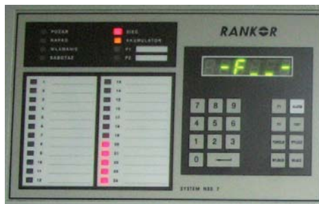
Fot. 1. Zobrazowanie uszkodzenia zasilania podstawowego i rezerwowego z wykorzystaniem diod LED
