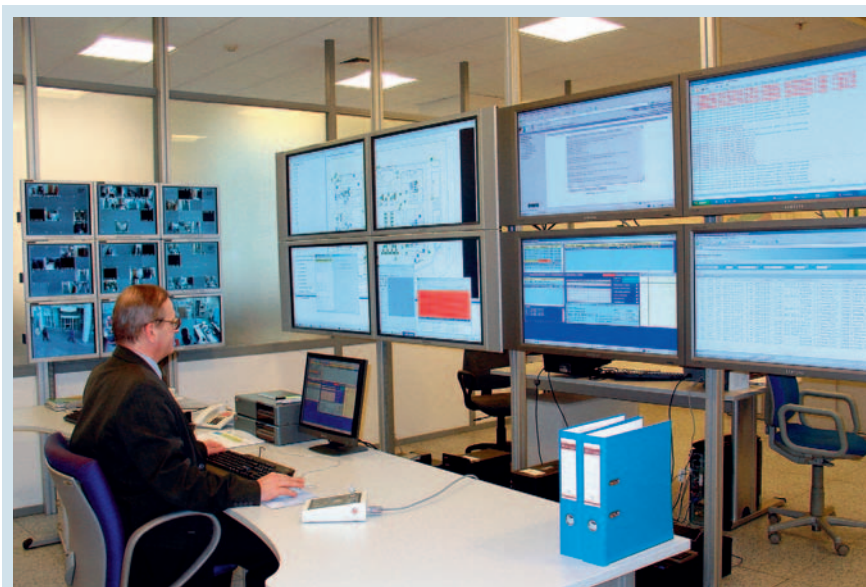
Fot. 1. Centralny Ośrodek Monitorowania Bezpieczeństwa
