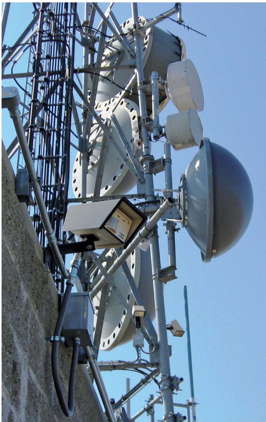
Fot. 1. Czujka Piramid XL2 zabezpieczająca wieżę telefonii komórkowej
