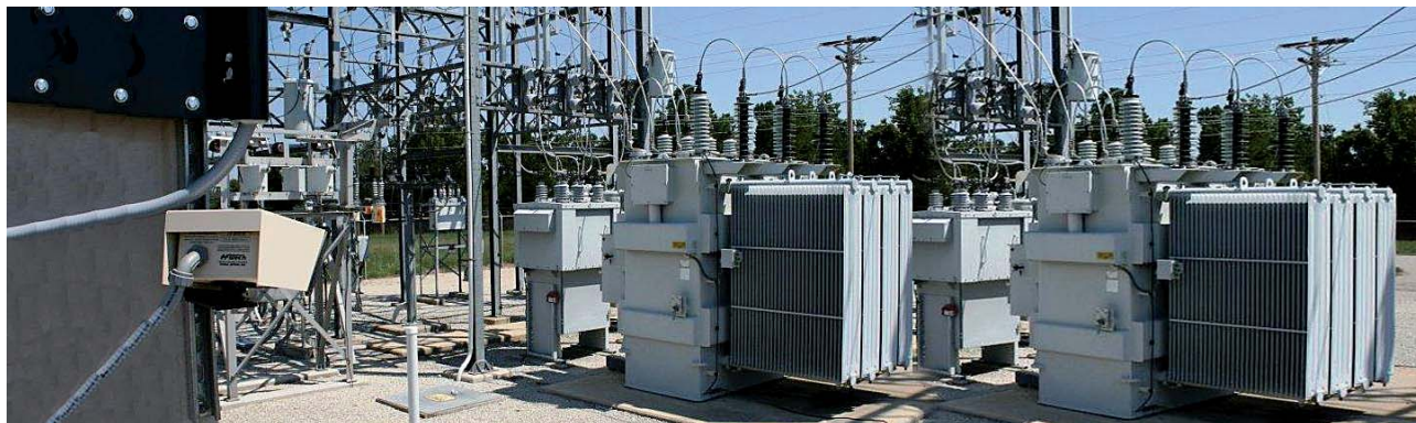
Fot. 2. Pyramid XL2 przy stacji przekaźnikowej
