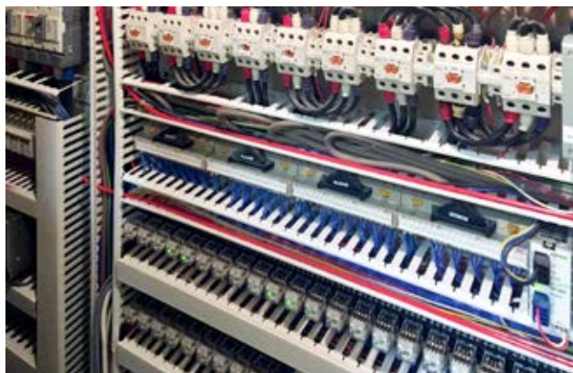
Fot. 1. Przewody detekcyjne (czerwone) w systemie PROTENG FM200
