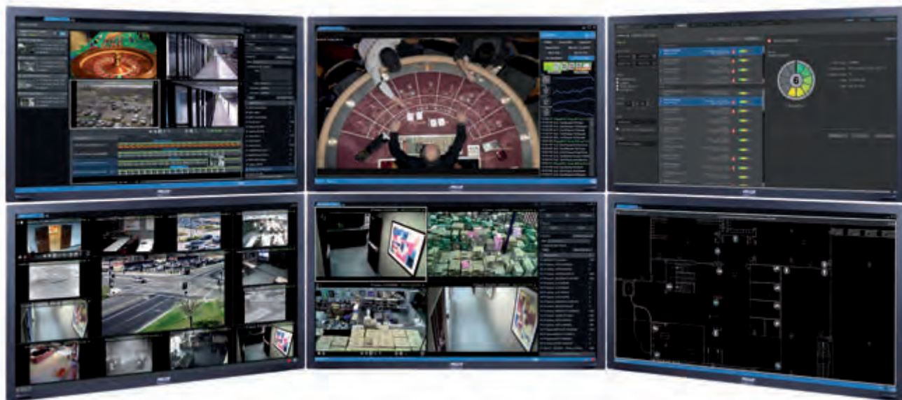
Fot. 1. Moduł Ops Center obsługuje do sześciu monitorów, z których każdy umożliwia wyświetlanie 16 obrazów
