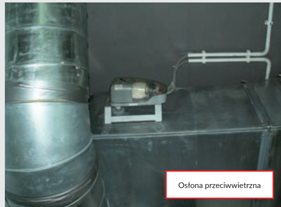
Fot. 3. Czujka w osłonie przeciwwietrznej zainstalowana na wlocie do klimatyzatora
