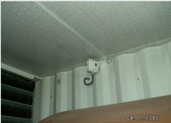
Fot. 6. Czujka płomieni nadzorująca agregat prądowórczy
