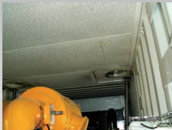
Fot. 5. Brak skutecznego nadzoru agregatu prądotwórczego
