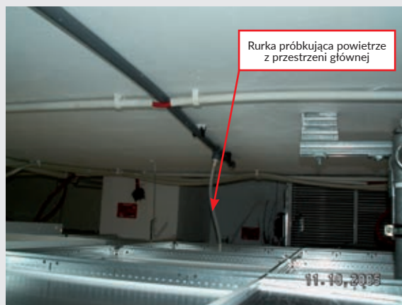
Fot. 1. Nadzorowanie przestrzeni głównej w serwerowni z wykorzystaniem systemu zasysającego zainstalowanego w przestrzeni międzystropowej
