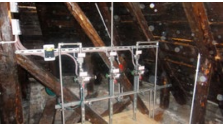
Fot. 2. Przykład zastosowania wysokociśnieniowej mgły wodnej (sanktuarium „Maria Śnieżna” na Górze Iglicznej)
