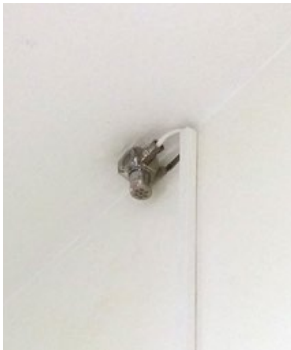
Fot. 1. Widok czujki gazu zainstalowanej pod stropem akumulatorni
