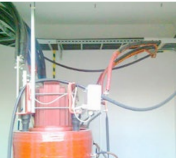
Fot. 4. Transformator suchy nieskutecznie nadzorowany za pomocą uszkodzonego, zwisającego systemu zasysającego
