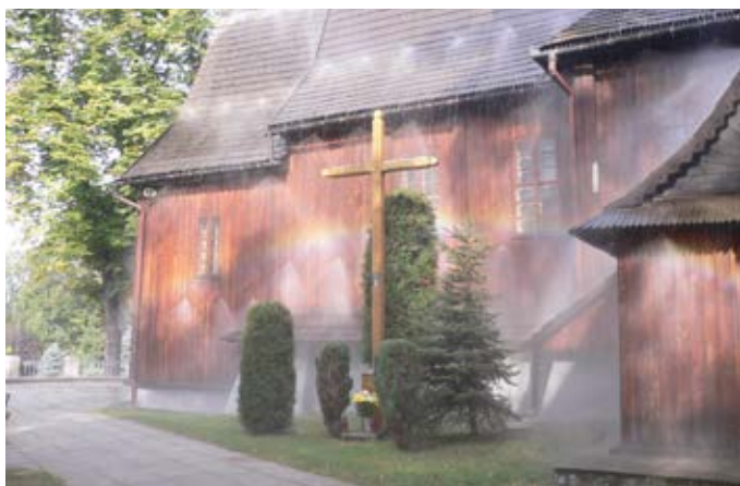
Fot. 1. Instalacja mgły wodnej w działaniu
