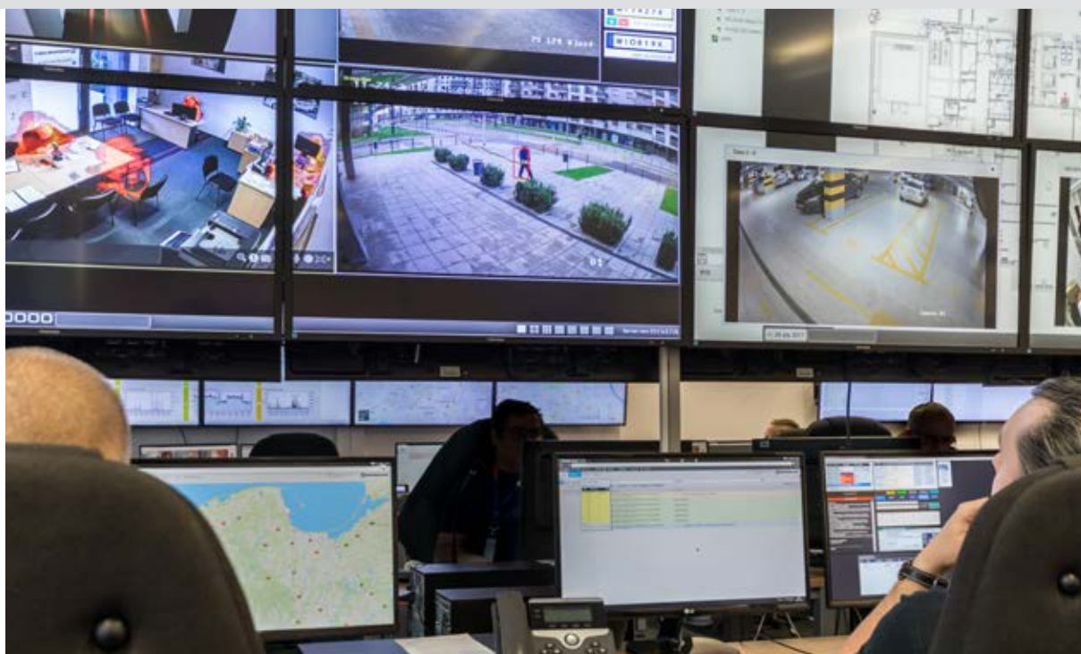
Fot. 1. Stacja monitorowania alarmów z kamer
