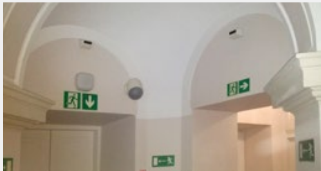
Fot. 1. Sposób rozmieszczenia czujek liniowych
