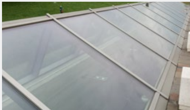
Fot. 4. Przykład nieskutecznego nadzoru
