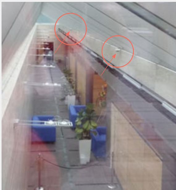
Fot. 3. Przykład nieskutecznego nadzoru
