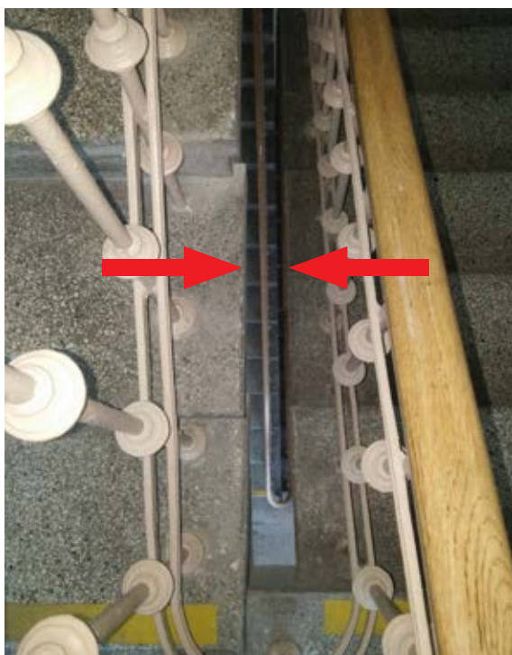
Fot. 1. Klatka schodowa o niskiej drożności pionowej. Mała, mniejsza niż 50 cm, odległość między biegami w dół i w górę
