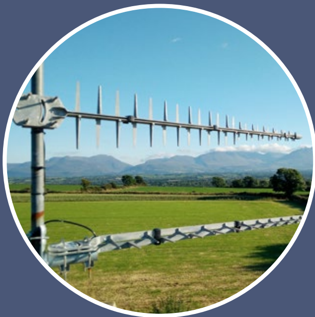
Fot. 2. Kierunkowe anteny Poynting LDPA-92 zapewniają połączenie ze stacją BTS na odległość 15 km (Autor: Fergus, Ireland)
