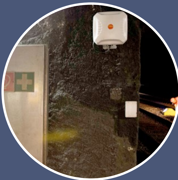
Fot. 5. Antena kierunkowa Poynting XPOL-2 LTE MIMO zamontowana w Tunelu Gotthard w Szwajcarii. Antena zapewnia komunikację z naziemną siecią telekomunikacyjną, dzięki czemu w tunelu można wyświetlać reklamy (Autor: Movinglight-design.ch).
