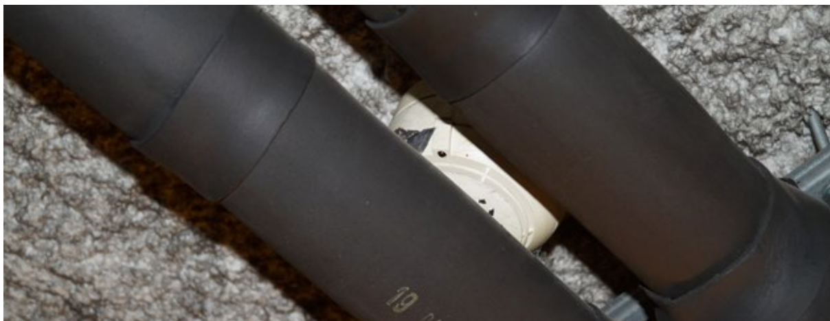
Fot. 1. Brak koordynacji lub uzgodnień dotyczących rozmieszczenia czujek pożarowych z projektantem lub wykonawcą instalacji wodnej. Czujka pokazana na zdjęciu jest praktycznie całkowicie zastonięta przez rury. Nie ma możliwości wzbudzenia alarmu pożarowego
